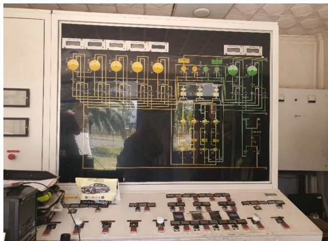
Figure III- 10 : Salle de contrôle des équipements (Sidi Arcine centre vrac 165)
