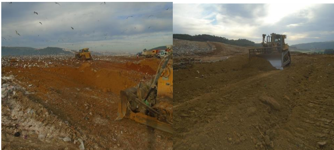
Figure 17 : Tassement et couverture du casier d'enfouissement
